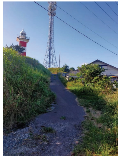
写真7 津波の避難経路(2) 道路舗装が途中されておらず、路上の 真ん中にも草が生えており、つまづく 可能性がある。
