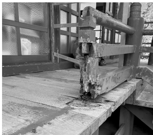
写真5 社の損傷部分
