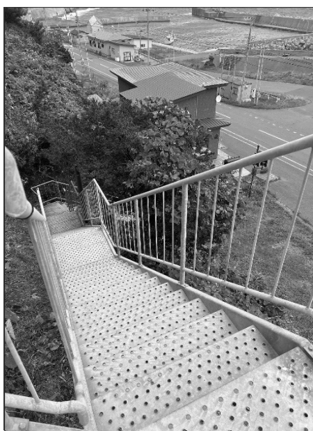
写真4 避難路の階段
