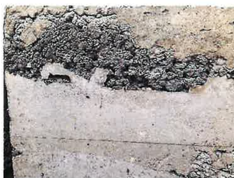
写真 1 外壁に発生した変状
