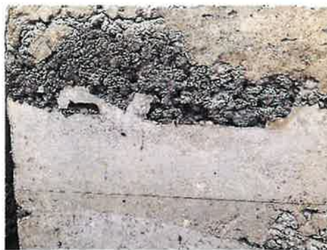
写真1 外壁に発生した変状
