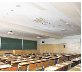
エアコンが設置された32番教室
